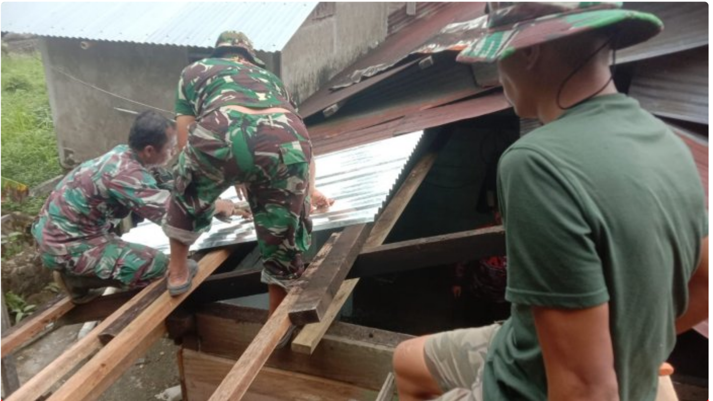
Satgas TMMD ke- 118 Wiltas Kodim 0910/Malinau Pasang Atap RTLH milik Bapak Ardian.
